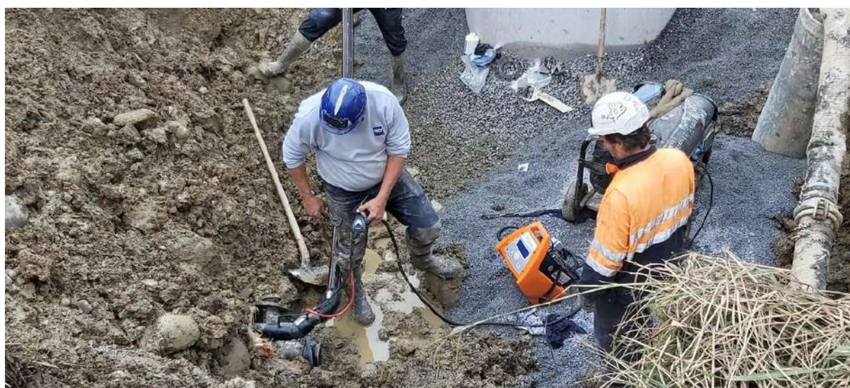
Electro-soudage de la conduite de refoulement du poste de relevage du Domaine St Georges (AJIR) à Montaut.
