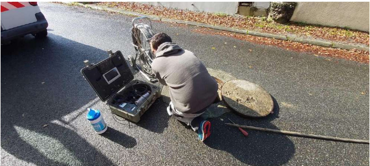
Investigation du réseau d'assainissement de Bénégacq avec la caméra de l'unité de Police de branchements
