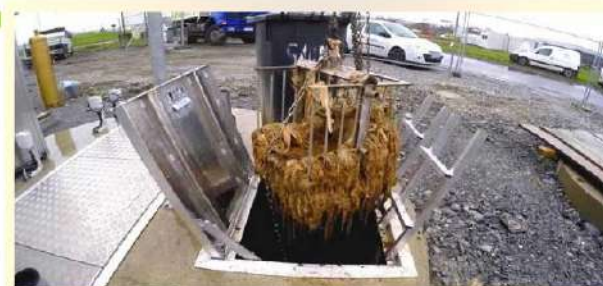
Panier de dégrillage de la station d'épuration d'Assat-Bordes
