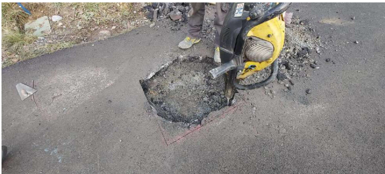
Accès impossible à un tampon de regard de visite d'assainissement, nécessitant une intervention lourde et coûteuse pour le remettre à la cote de la voirie.
